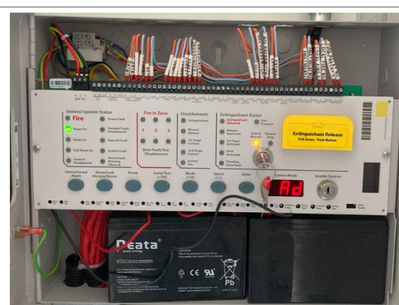
Abbildung 4-12: Verbinden der Bleibatterien
