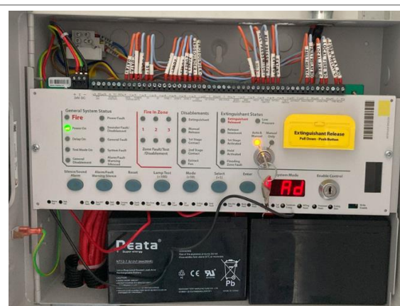
Figure 4-12 : Connexion des batteries au plomb
