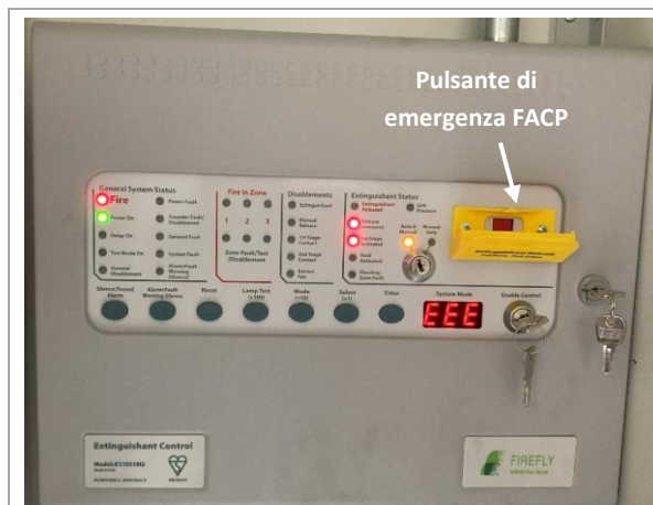
Figura 4-13: Vista della FACP durante il processo di spegnimento
