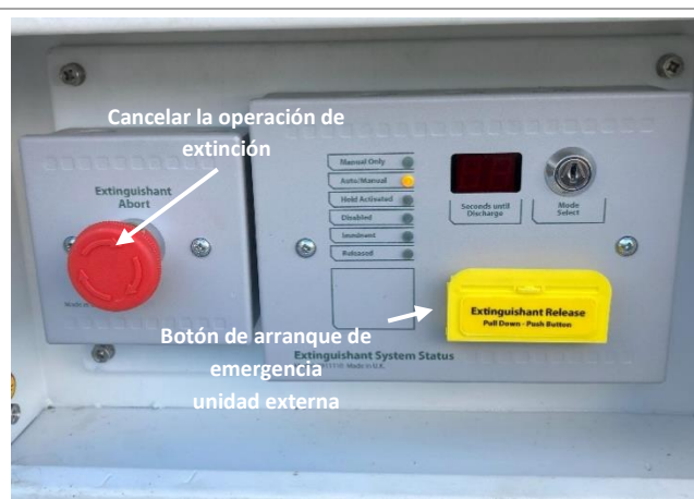
Figura 4-14: Vista de la unidad externa
