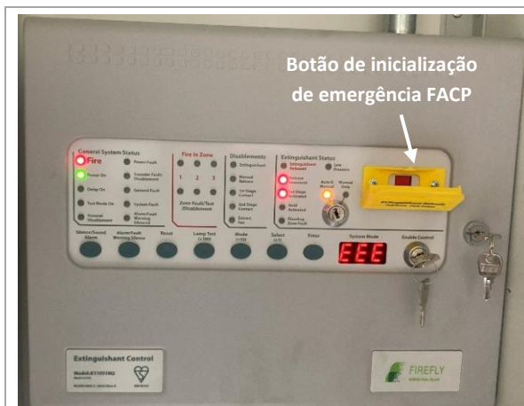
Figura 4-13: Visão do painel central de alarme de incêndio durante o processo de extinção
